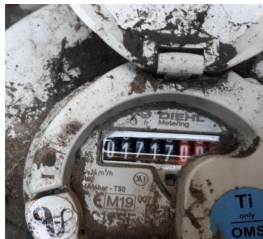
Figure : Photo du compteur du reseau eau public
