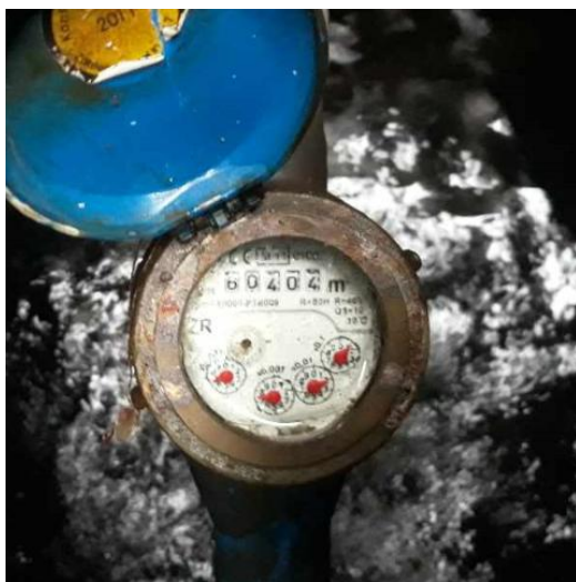
Figure : Photo du compteur du forage
